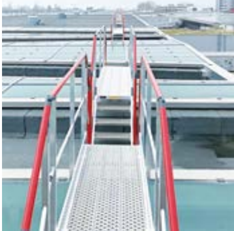
Sauts de loup pour sécurisation cheminement sur toitures
