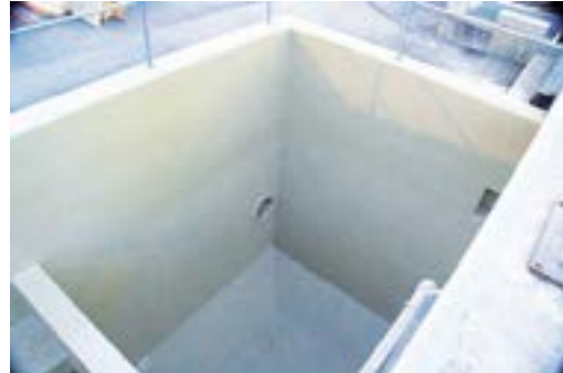
Résine polyurée anticorrosion projetée à chaud Fosse de station de traitement d'eau industrielle
