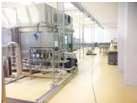
Résine polyuréthane-ciment autolissante Salle blanche d'embouteillage
