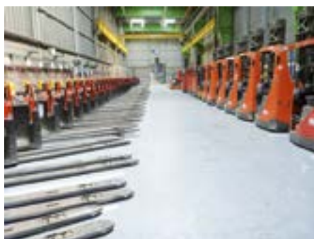
Résine époxy antidérapante et anticorrosion Local charge batteries en logistique
