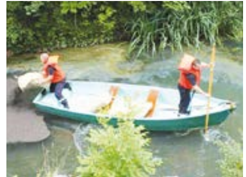
granulés pour hydrocarbures
